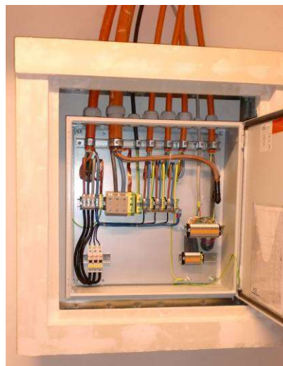
Bild 5, Verteiler als BSV-Gerät-Ersatz (SV-Bypass)
